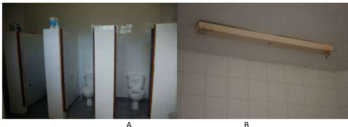
Figura 4.226 Banheiro feminino da edificação anexa ao Centro de Visitantes do PNM de Grumari (A) e detalhe da luminária sem lâmpada (B). Fonte: Detzel Consulting, 2012.
