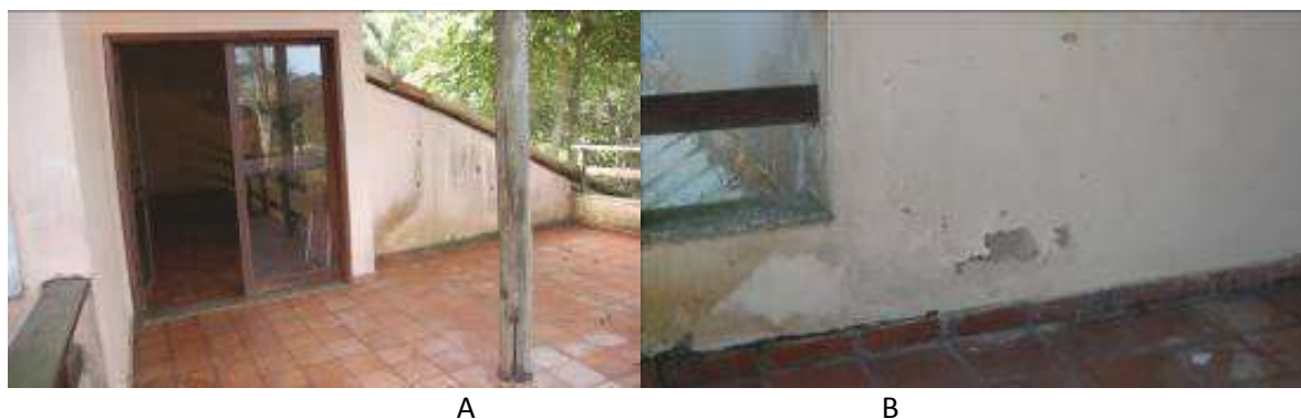
Figura 4.186 Varanda do 2º pavimento (A) com detalhes das paredes sem reboco e pintura desgastada. Fonte: Detzel Consulting, 2012.
