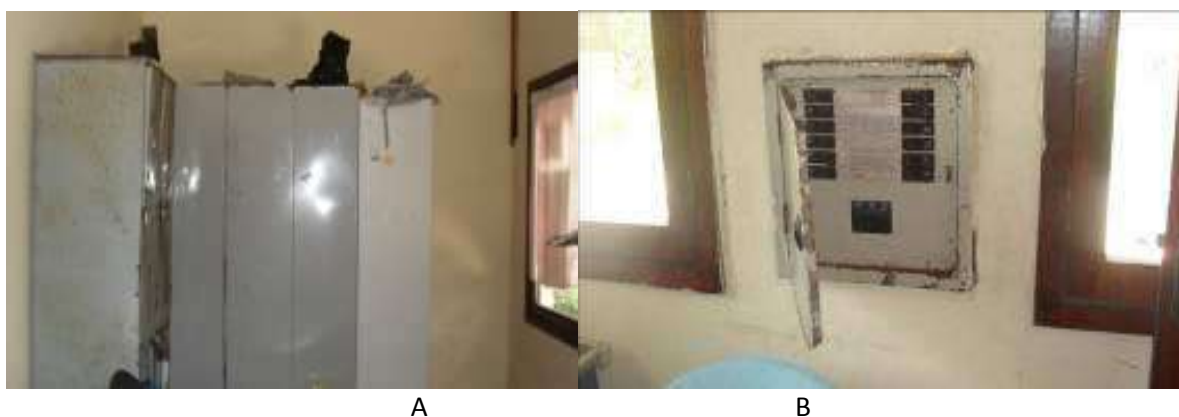
Figura 4.189 Detalhe dos armários (A) e do quadro de luz do prédio de segurança e manutenção do PNM da Prainha. Fonte: Detzel Consulting, 2012.
