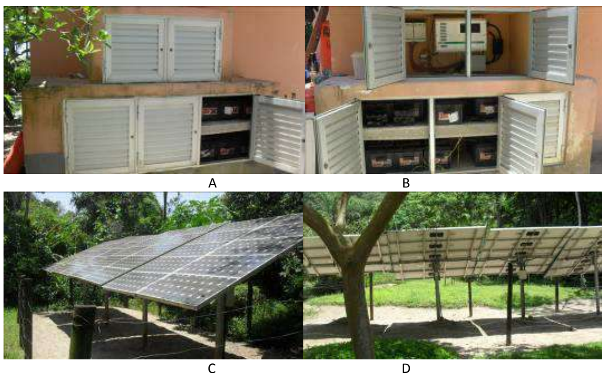
Figura 4.202 Sistema de painéis fotovoltaicos do PNM da Prainha. Fonte: Detzel Consulting, 2012.
