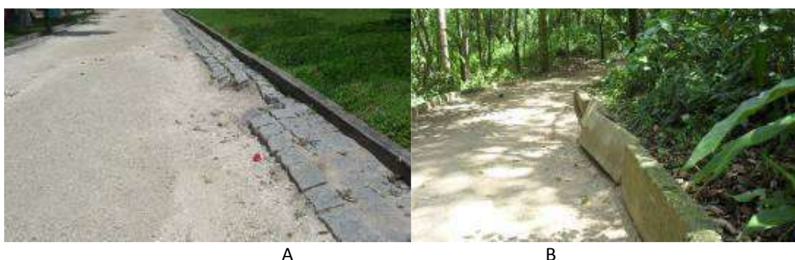
Figura 4.209 Problemas pontuais nos caminhos, com a ocorrência de paralelepípedos soltos (A) e pedras deslocadas (B). Fonte: Detzel Consulting, 2012.
