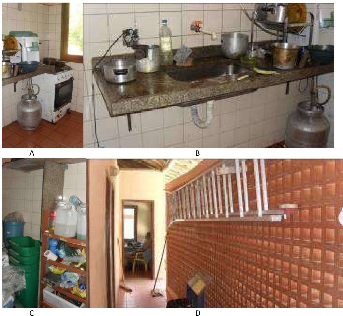
Figura 4.191 Detalhe da cozinha com fogão deteriorado (A) e localização do botijão de gás (B); Detalhe do sanitário feminino com material de limpeza (C) e circulação do prédio (D). Fonte: Detzel Consulting, 2012.
