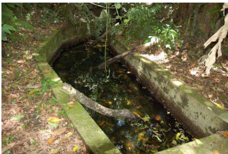
Figura 4.195 Reservatório de água que abastece os chuveiros externos. Fonte: Detzel Consulting, 2012.
