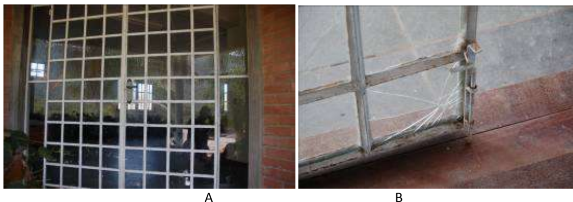
Figura 4.218 Esquadria em ferro (A) com detalhe do acabamento e vidro quebrado (B). Fonte: Detzel Consulting, 2012.
